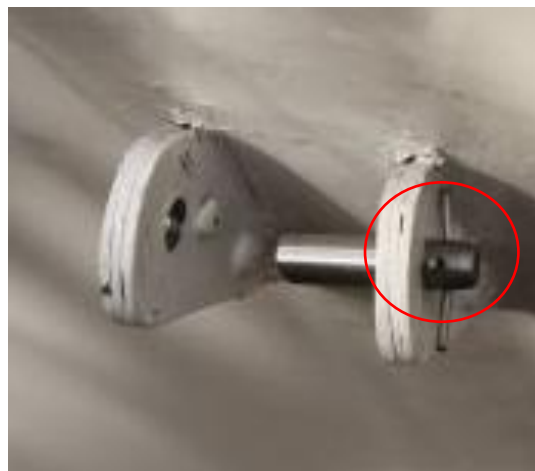
... zbytek čepu spoje vzpěra/křídlo a způsob zajištění čepu
