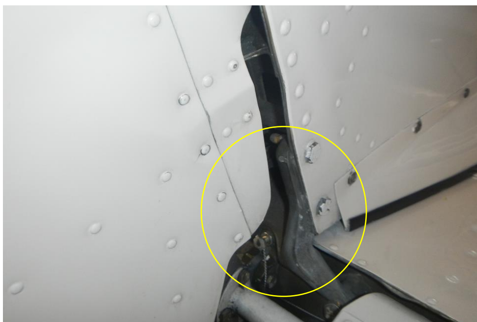
Obr. 5 – Poškozený zadní silový uzel spojení svislé a vodorovné ocasní plochy.
