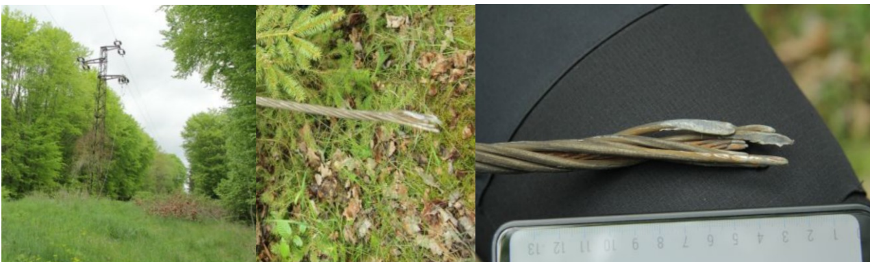
Obr. č. 5 – Sloup s přeseknutým koncem vodiče na levém břehu
