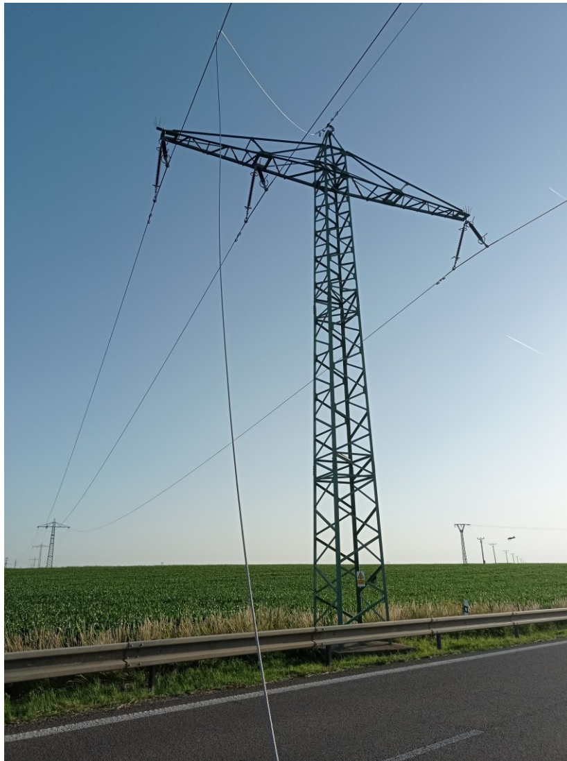
Obrázek 1 – Místo události, stržený zemní vodič vedení V501 a podpěrný bod č.196.
