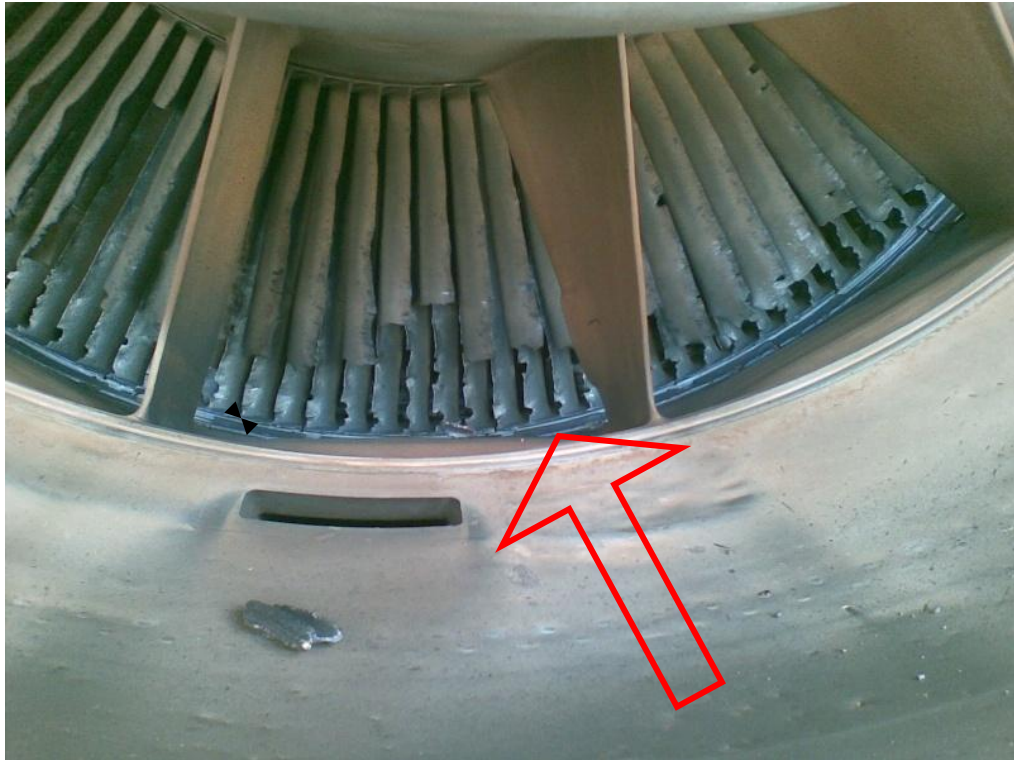
Poškození lopatek nízkotlaké turbíny motoru č.2
