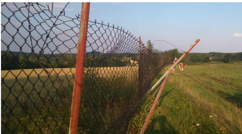
Obr. 2: Pohled na poškození plotu ohraničující letiště LKKV
